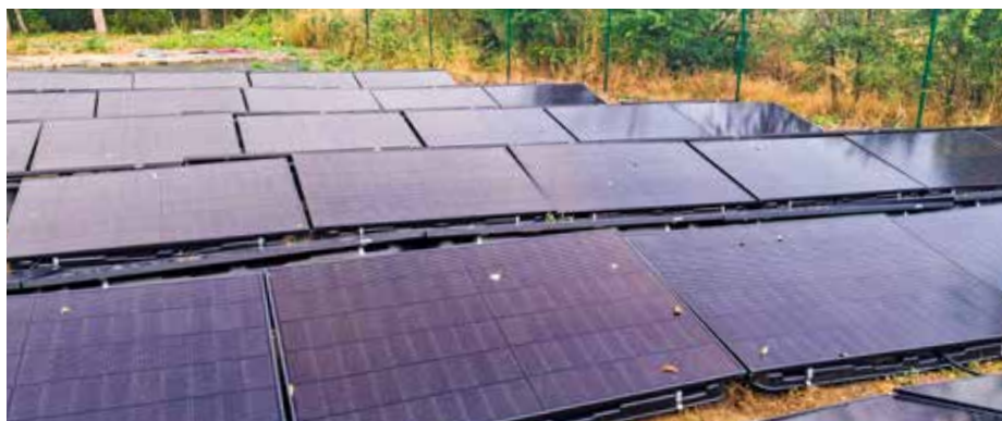
Fotovoltaická elektrárna v areálu ČOV
