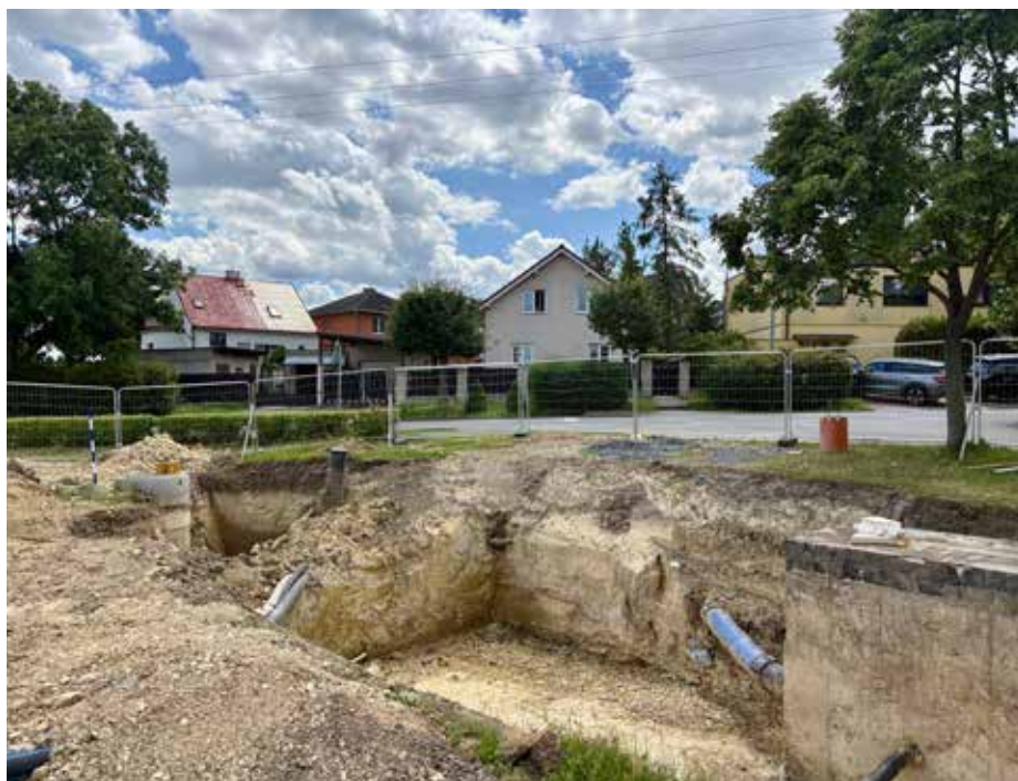
Armaturní šachta v Zelenči
