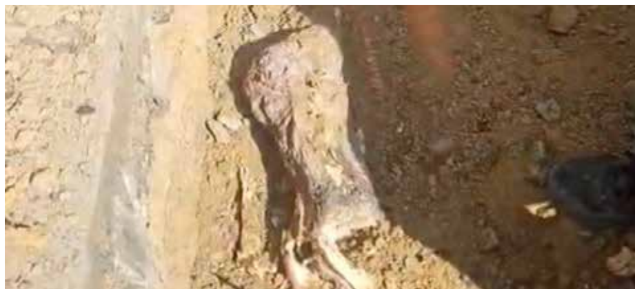
Příklad poškozené chráničky způsobené prorůstáním kořenů
